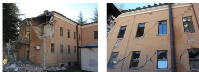
Figura 2. Fotografie del danno all' 8 Dicembre 2016 di S. Cattari e D. Sivori. A sinistra, meccanismo di ribaltamento fuori dal piano. A destra, danneggiamento prevalente a taglio nei maschi e nelle fasce .
