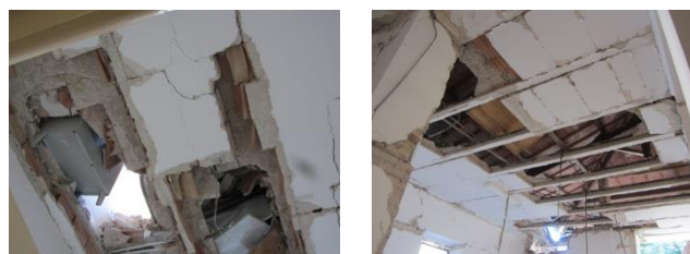
Figura 3. Fotografie del danno all' 8 Dicembre 2016 di S. Cattari e D. Sivori. Collasso di un solaio di latero-cemento al piano primo e di un solaio in putrelle e tavelloni al piano secondo.
