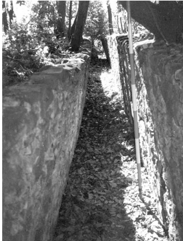
Fig. 4 – Particolare dello spanciamento dei paramenti della trincea maggiore, dovuto alla pressione del terreno.
