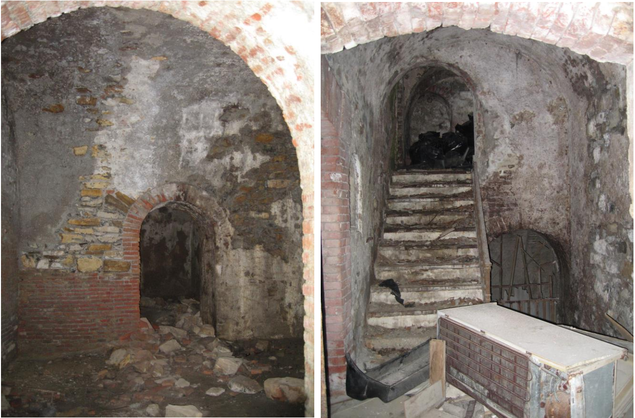
Fig. 17 - La galleria di controscarpa (foto A. Boato); Fig. 18 - Scala di collegamento tra la galleria di controscarpa e la Batteria di San Martino (foto A. Boato).
