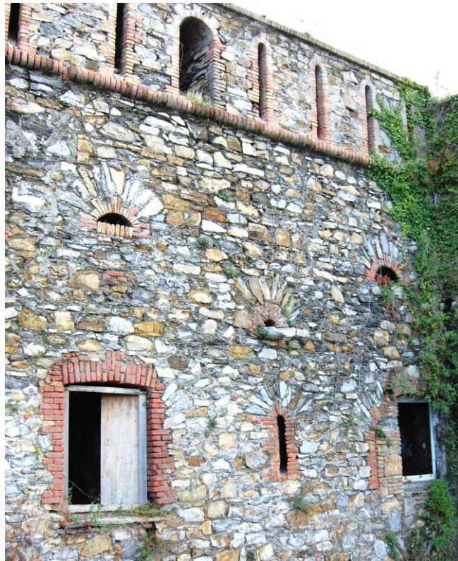
Fig. 14 - Caserma, particolare del fronte. Si notano diversi tipi di aperture e le loro trasformazioni: una cannoniera tamponata e trasformata in finestra rettangolare, lunette per l'evacuazione dei fumi di sparo, feritoie di due tipologie (foto B. Volpato).
