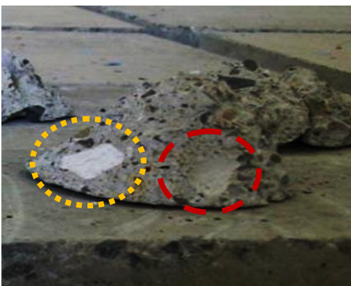
Figure 5 - Different aggregate behavior / diverso comportamento degli inerti
