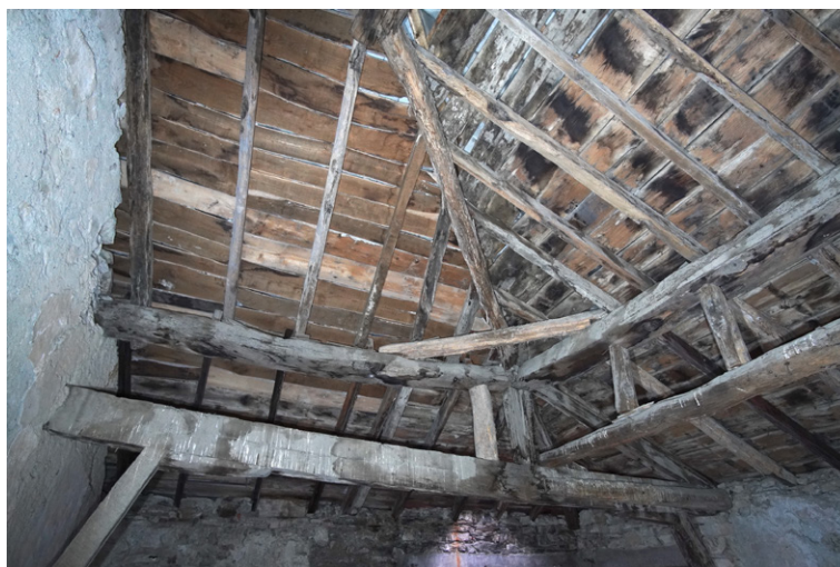
Fig. 5. Complessità delle strutture di copertura del Castello, frutto dei molteplici dissesti ed interventi di ripristino subiti nel tempo (foto C. Ferrero 2023). La copertura ha localmente perso la logica strutturale originaria.
