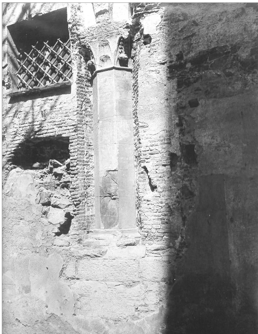
fig. 2 – Genova. Palazzo Ducale, scrostamento dei resti del palazzo del Comune, 1910 (Doc-Sai, archivio fotografico, 25970).
